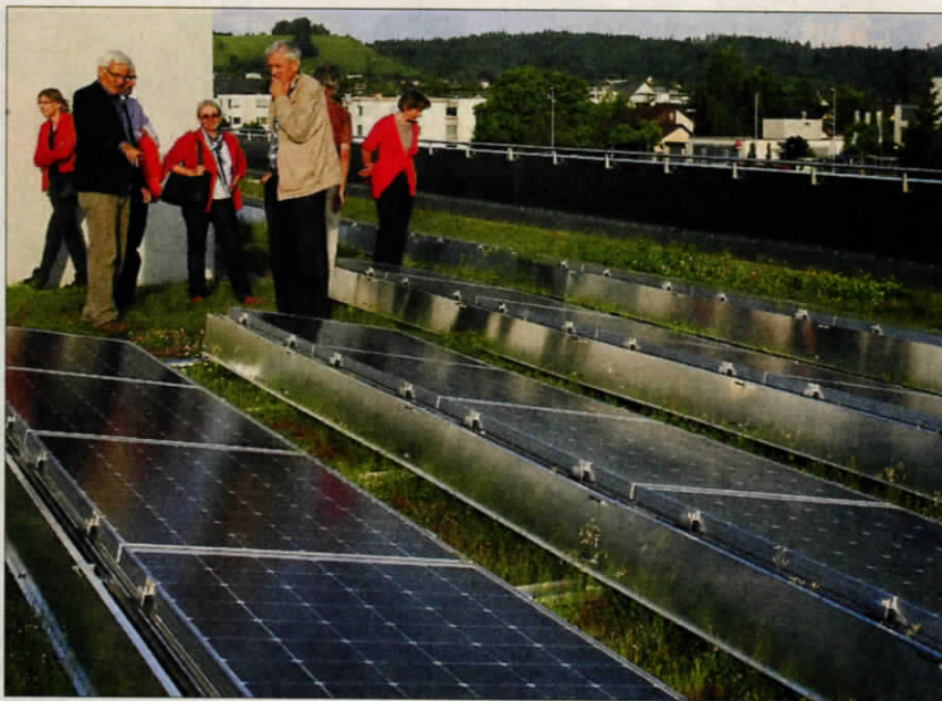
Gallus Zano (li.) erläutert Stadträtin Heidi Berner (Mitte) und Interessierten die Bauweise der Anlage.
