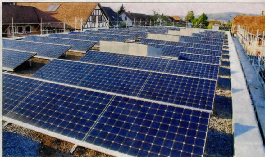
Die Anlage auf dem Gemeindehausdach.
